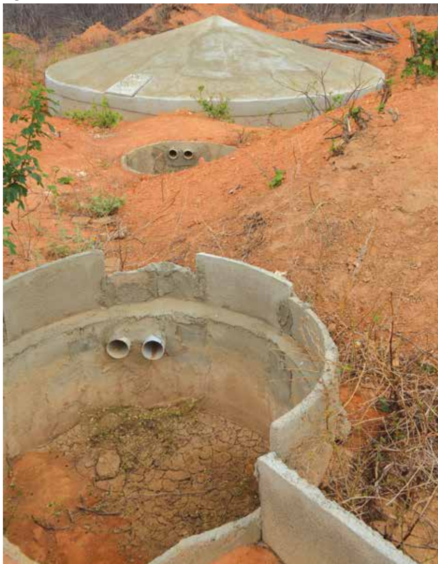
Figura 6: Cisterna de enxurrada
